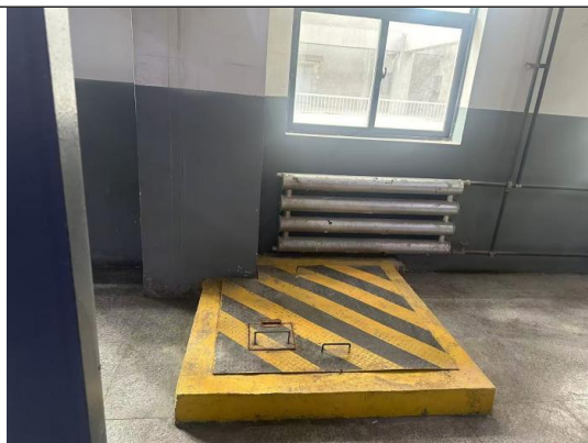
氯化钠原液事故水池
