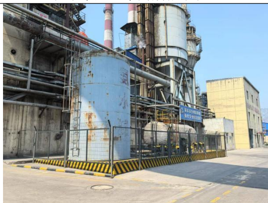
氨水罐及围堰
