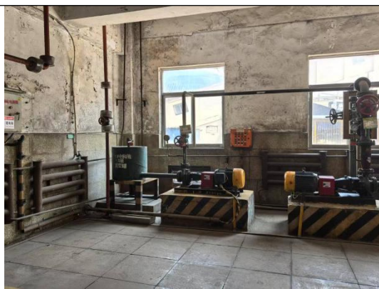
化学水处理车间酸碱中和池
