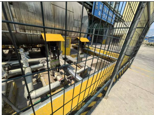
氨水罐、高分子脱硝罐围堰内部收集池
