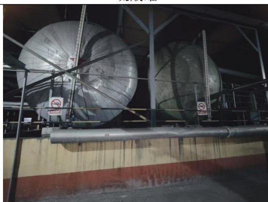
中水处理盐酸罐及液碱罐
