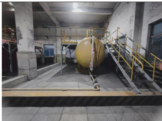
化学水处理车间液碱罐及围堰
