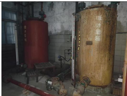
化学水处理车间酸碱计量槽
