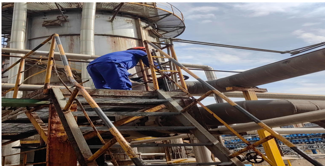
③当班人员及时将槽罐内脱硫液打入事故槽
