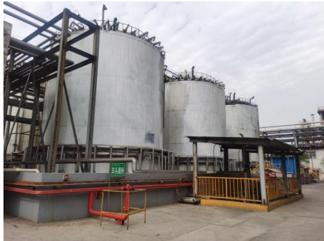
炭微球工序 1000 方槽区
