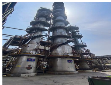
精萘工序精塔、苋塔
