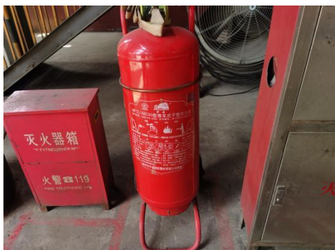
精蒽工序消防器材
