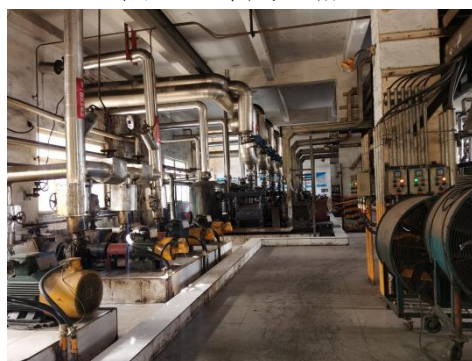
焦油工序泵房
