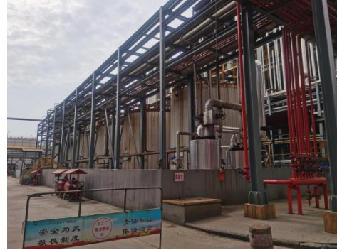
炭微球工序 150 方槽区
