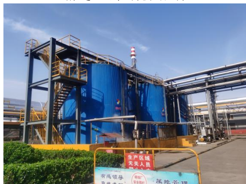
精蒽工序蒽油槽区
