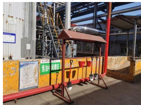
焦油工序消防设施
