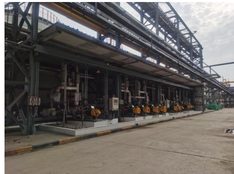
炭微球工序 500 方泵区
