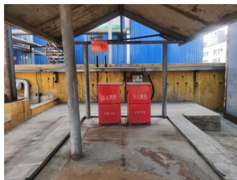
2-萘酚工序酸碱罐区消防设施
