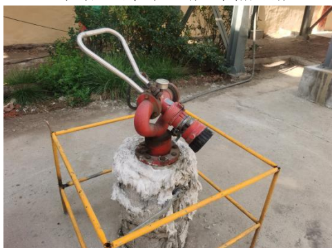
2-萘酚工序消防设施
