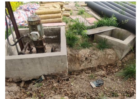
化工厂初期雨水池
