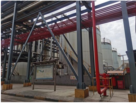
炭微球工序 500 方槽区
