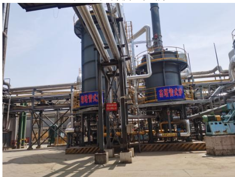
精萘工序管式炉区
