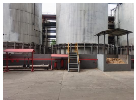
炭微球工序消防设施
