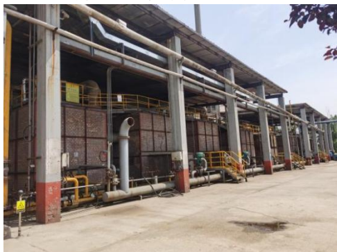
精蒽工序熔盐炉、热风炉
