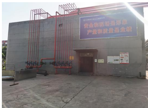
焦油工序消防站
