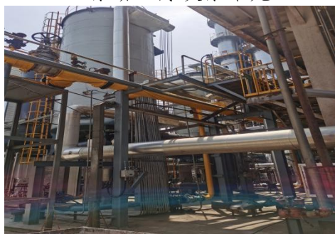
2-萘酚工序熔盐炉导热油炉
