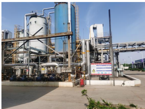
精蒽工序导热油炉区
