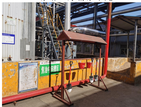
焦油工序消防设施
