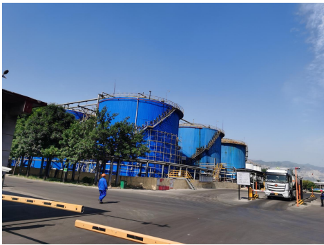
焦油工序原料槽区
