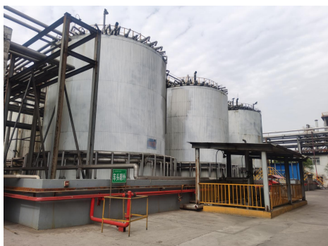
炭微球工序 1000 方槽区
