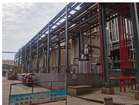
炭微球工序 150 方槽区
