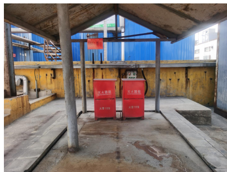
2-萘酚工序酸碱罐区消防设施
