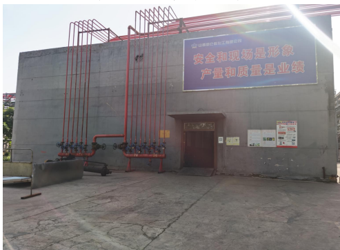
焦油工序消防站
