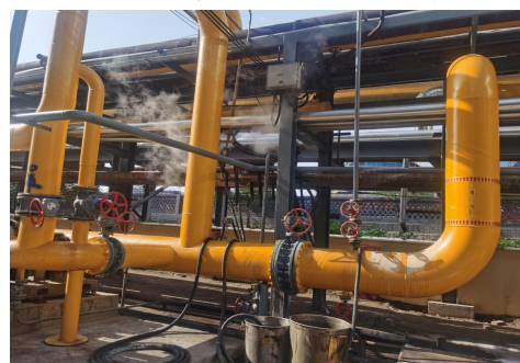
厂区焦油煤气管道
