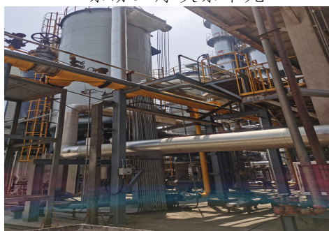
2-萘酚工序熔盐炉导热油炉
