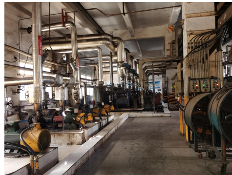
焦油工序泵房
