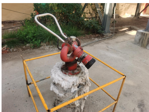
2-萘酚工序消防设施
