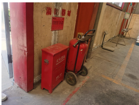
卡唑库房内消防设施
