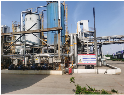
精蒽工序导热油炉区
