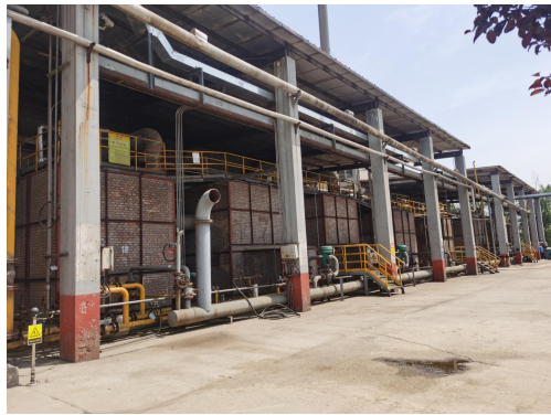
精蒽工序熔盐炉、热风炉
