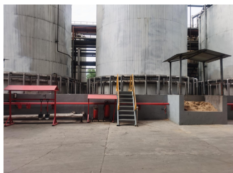
炭微球工序应急设施
