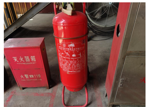
精蒽工序消防器材
