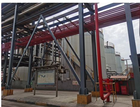
炭微球工序 500 方槽区
