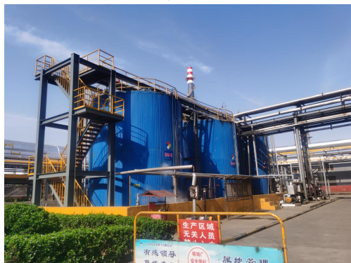
精蒽工序蒽油槽区
