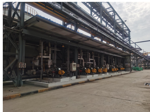
炭微球工序 500 方泵区
