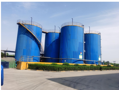
2-萘酚工序酸碱罐区
