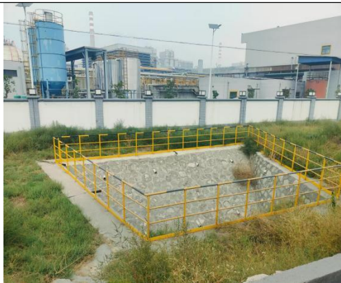
水处理区雨水排口
