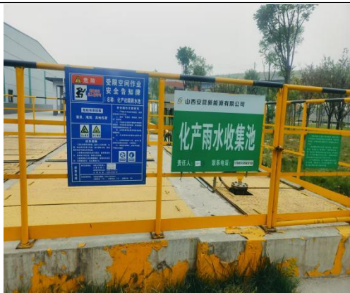
化产雨水初期雨水池
