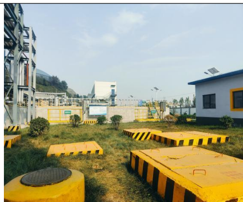
水处理区雨水池
