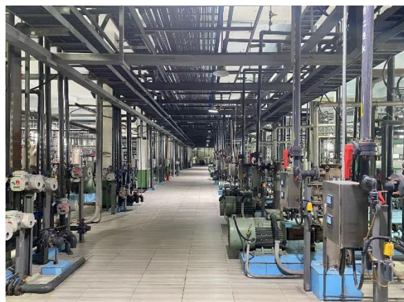
（清净水处理站）
