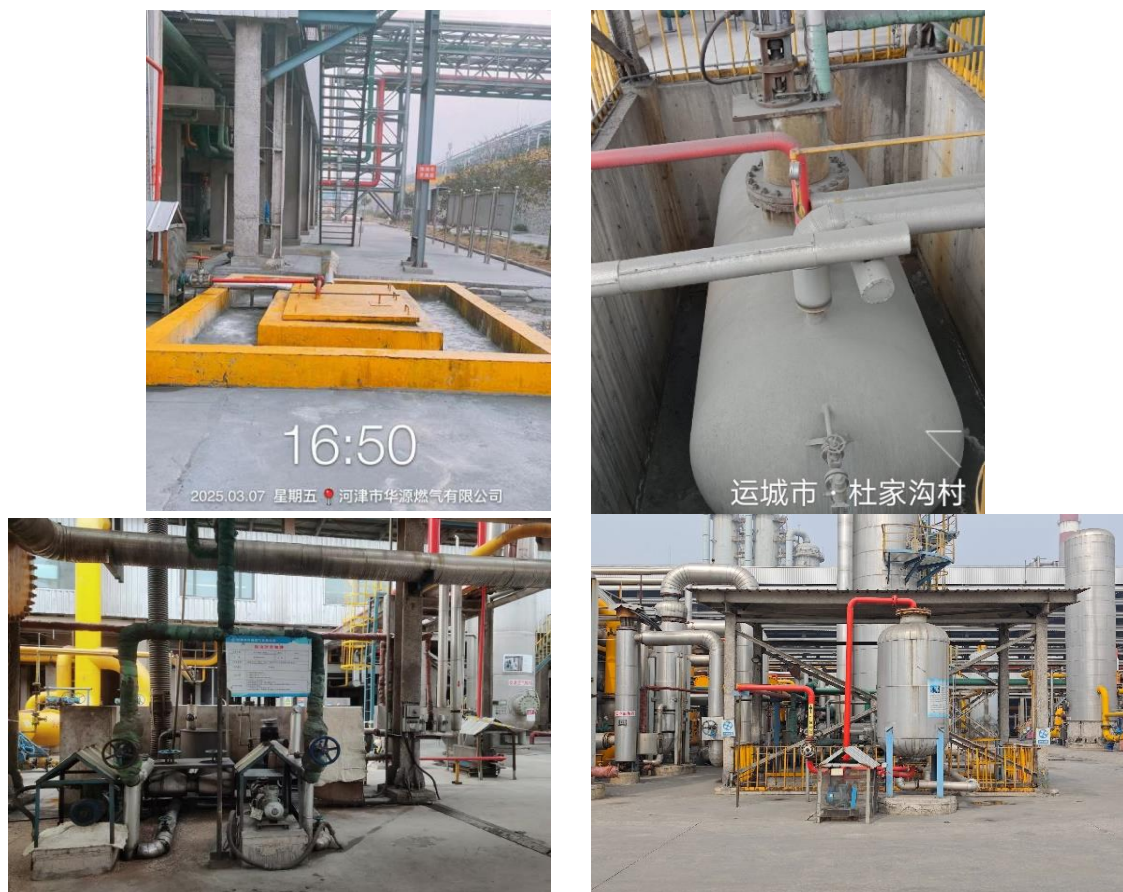
图 3.3-13 现有厂区高浓废水收集池及活性炭吸附装置
